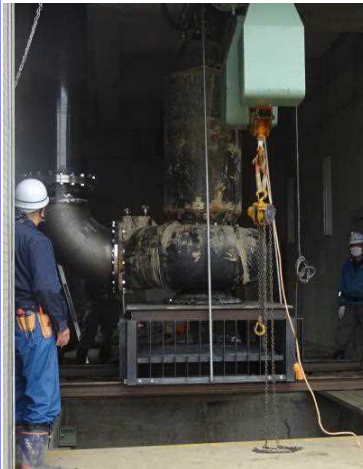
仮設ポンプの設置 (長野県 千曲川流域下流処理区終末処理場)
