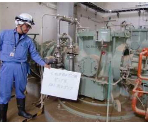
ポンプの浸水状況 (広島県三原市)
