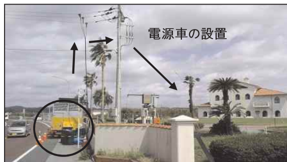
電力会社の電源車による受電
