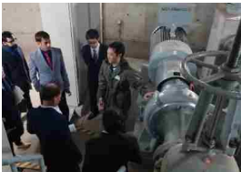
横浜市施設見学(第二ポンプ)
