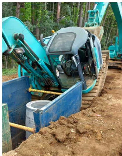
地盤崩落時の様子
