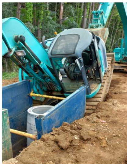
地盤崩落時の様子
