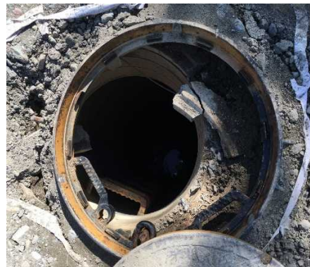
被害状況（厚真町）
