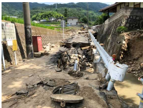
被災状況（海田町）
