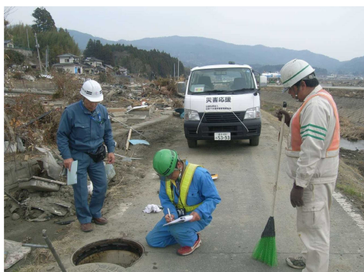
被災調査状況（岩手県大船渡市）
