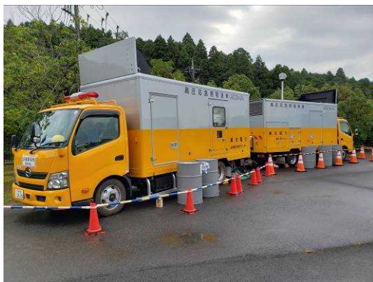
電源車設置状況（芝山 C C）
