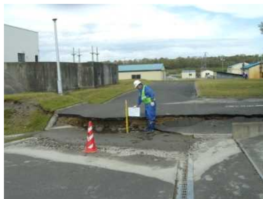
鶴川終末処理場内の地盤沈下
