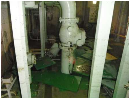
高梁浄化センター内の浸水状況
