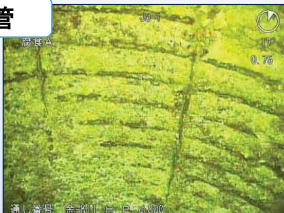
腐食による鉄筋露出
