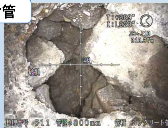
取付管異常（閉塞不良）
