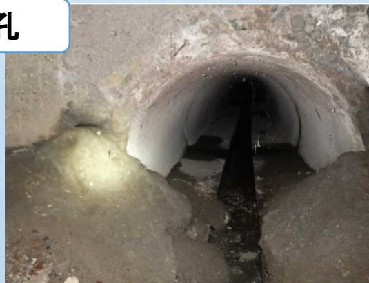
管口の破損・堆積
