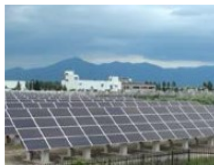
山形県 山形浄化センター
