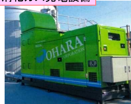
消化ガス発電設備
