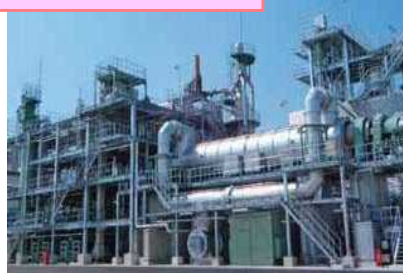
固形燃料化施設
