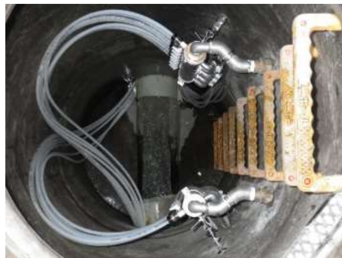
写真 2 マンホール内設置状況
