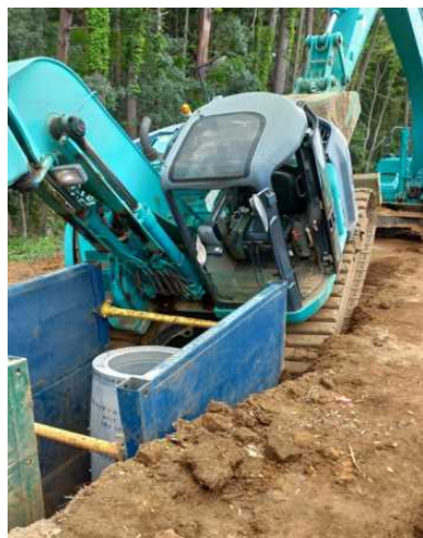
地盤崩落時の様子
