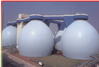
メタン発酵槽
