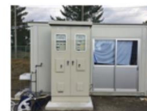
現場実験室および制御盤
