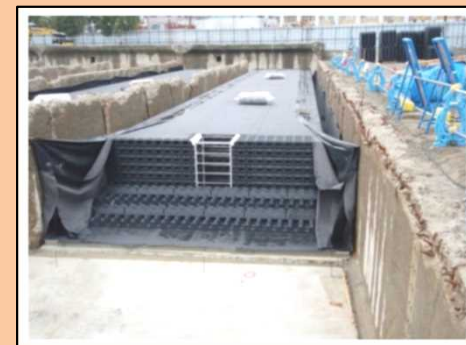
雨水貯留施設の整備状況
