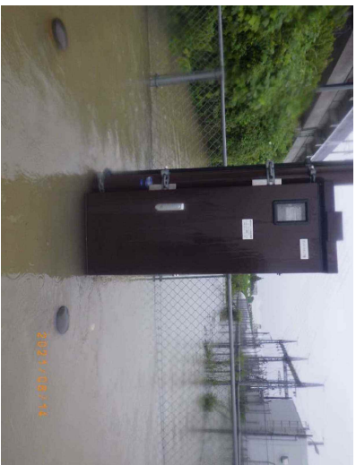
浸水したマンホールポンプ制御盤
