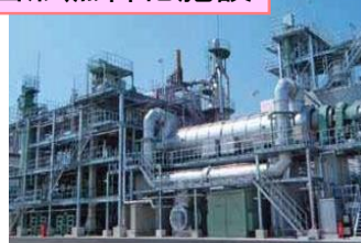
固形燃料化施設
