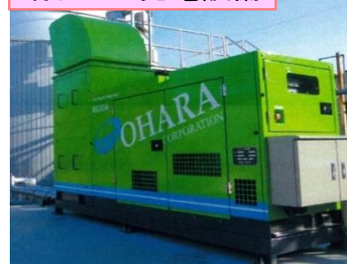
消化ガス発電設備
