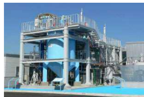
神戸市のりん回収設備
