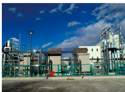
鬼怒川上流浄化センター 発電設備(燃料電池2台)
