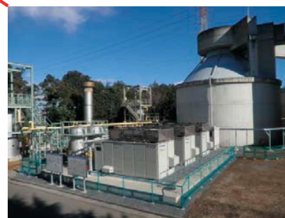
県央浄化センター 発電設備(燃料電池3台)
