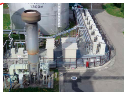
北那須浄化センター 発電設備(ガスエンジン8台)
