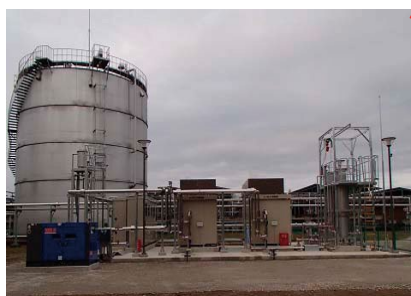
巴波川浄化センター 発電設備(燃料電池2台)
