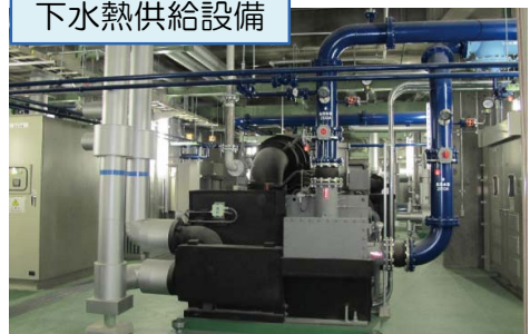
下水熱供給設備
