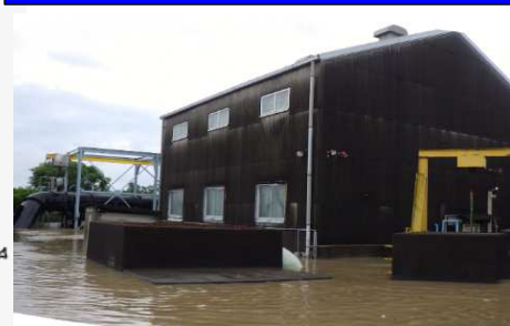
浸水した雨水ポンプ場
