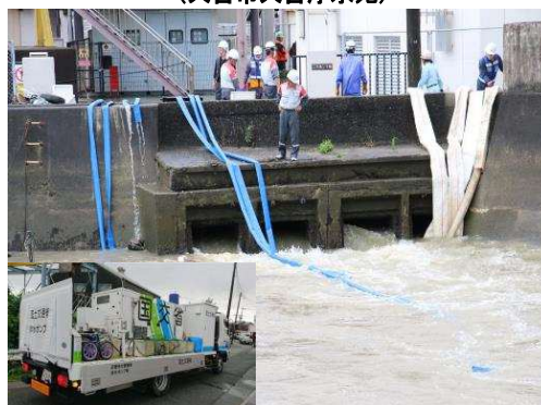
排水ポンプ車によって雨水を排水 (大牟田市三川ポンプ場)
