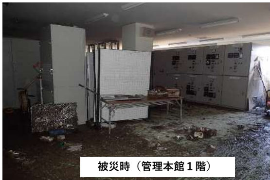
管理本館電気室
