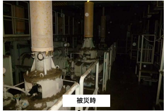
ポンプ棟揚水ポンプ
