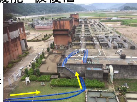
簡易処理(揚水、沈殿、消毒機能 仮復旧)
