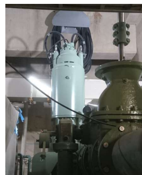
人吉市浄水苑 水中ポンプ R4.5撮影
