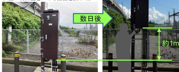
28 制御盤を上げる前
