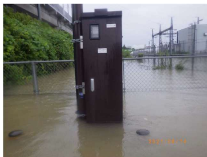
26 浸水したマンホールポンプ制御盤
