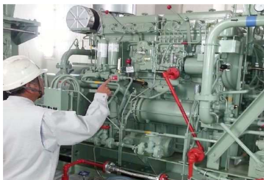
(13) 緊急点検(野上P・ポンプエンジン確認)
