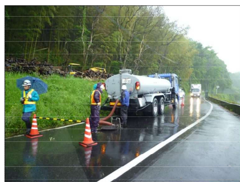
流域下水道マンホールへし尿投入
