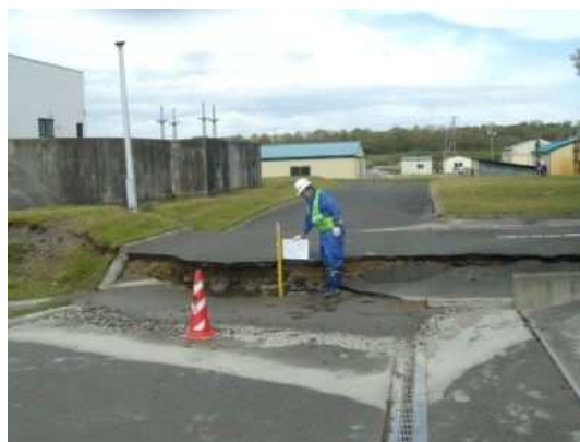
鶴川終末処理場内の地盤沈下
