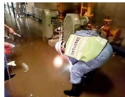
益城町浄化センターでの被害状況調査(4/16)
