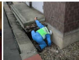
嘉島町上六嘉汚水中継ポンプ場での被害状況調査(5/11)
