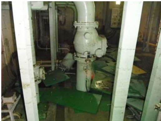
高梁浄化センター内の浸水状況
