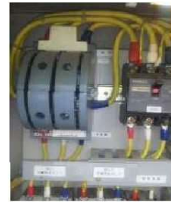
商用から発電機に切り替える
