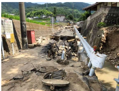
被災状況 (海田町)
