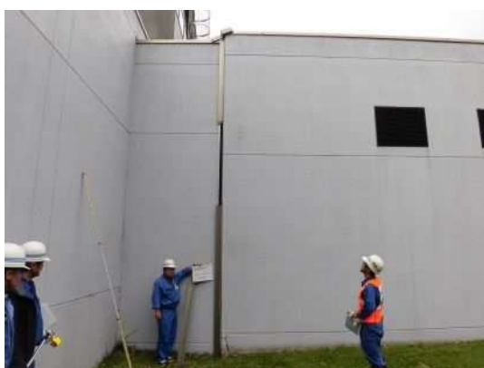
早来浄化センターの構造物継目部のズレ
