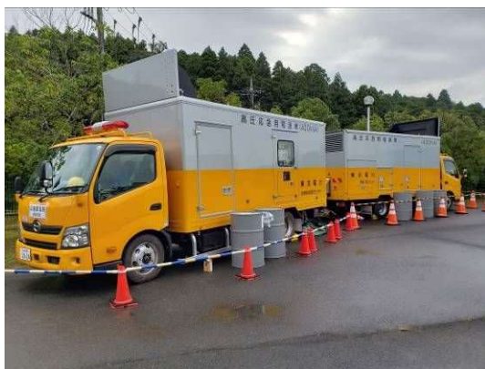
電源車設置状況（芝山CC）
