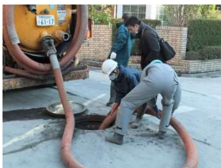
管路施設の調査だけでなく、業者手配から指揮系統まで全面的な支援を受けた（浦安市）
