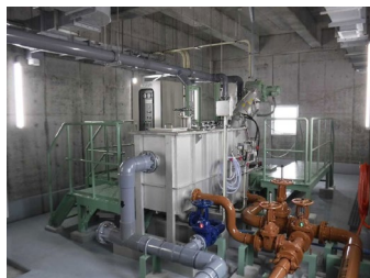
【し渣除去脱水装置】
