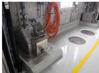
【受入口と受水槽】
