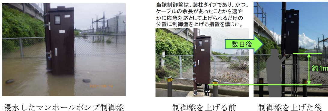
図 4-1 マンホールポンプ制御盤の嵩上げ事例
