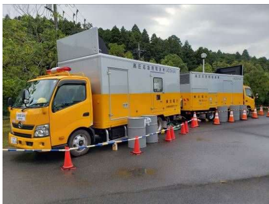
電源車設置状況（芝山CC）
