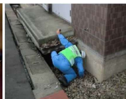
嘉島町上六嘉汚水中継ポンプ場での被害状況調査(5/11)
