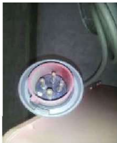
発電機用のケーブルジャック (ポンプ能力により形状が違うため、事前に確認すること)
