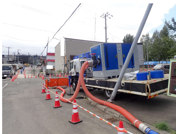
緊急水替え用にエンジンポンプユニットを提供（札幌市）
