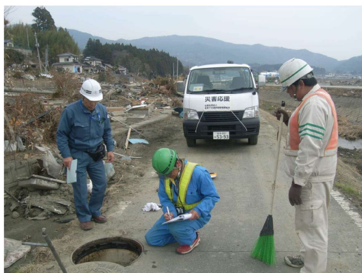
被災調査状況 (岩手県大船渡市)
