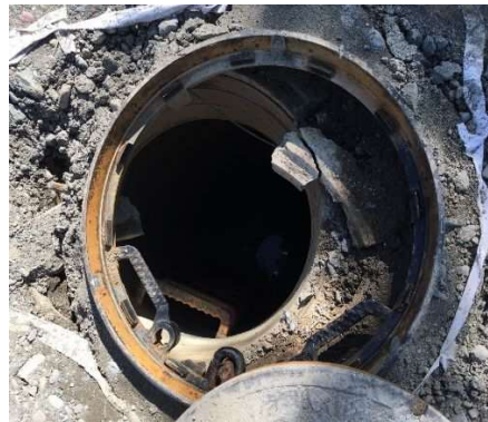
被害状況 (厚真町)
