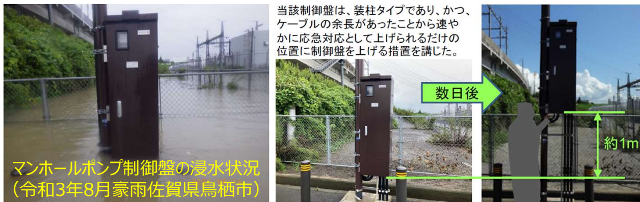
前回の改訂以降の浸水対策の事例（操作盤を高所移設した例）
