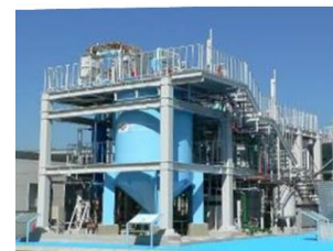
リン回収施設 (神戸市)
