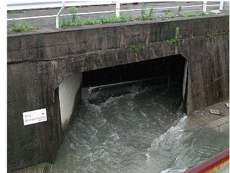
ろ過スクリーンを設置した吐口 出典：京都市HP
