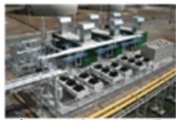
消化ガス発電
