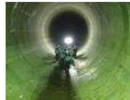
雨水貯留管(東京都)
