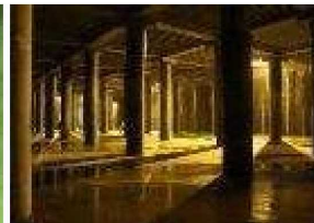
貯留施設(福岡市)
