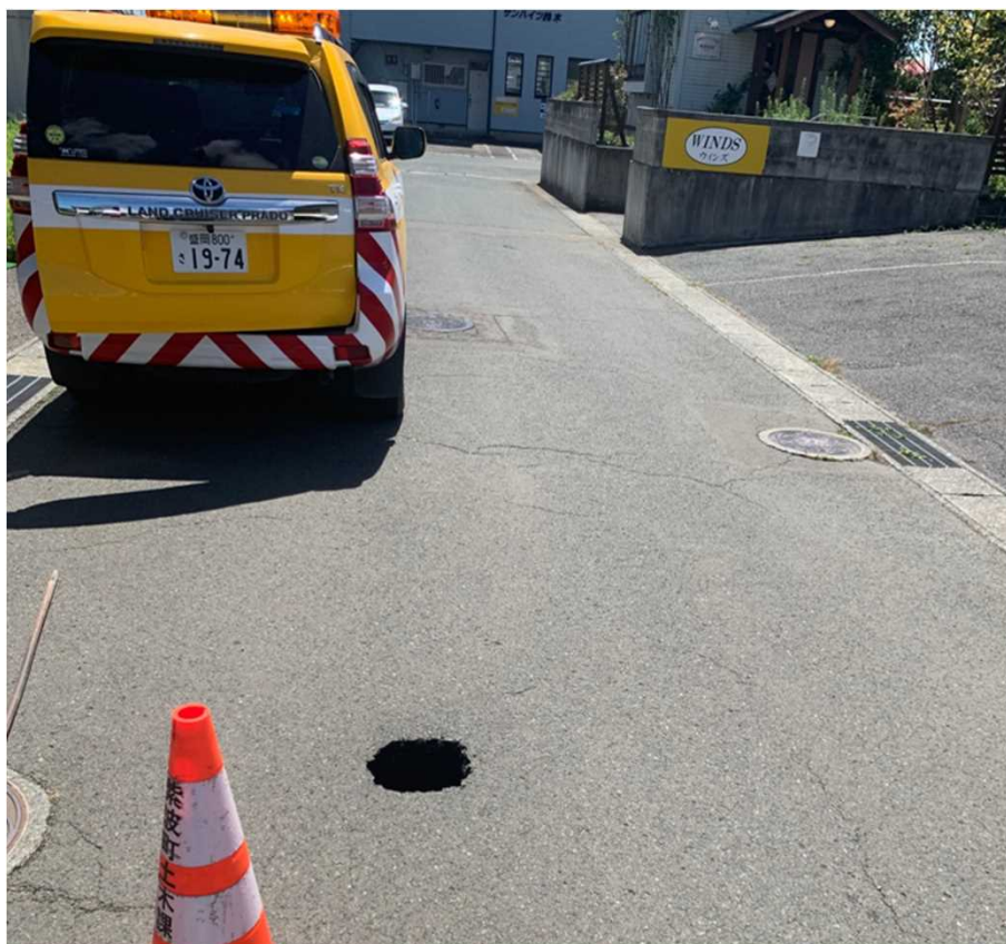
道路パトロール中、下水道管埋設箇所で道路陥没を発見
