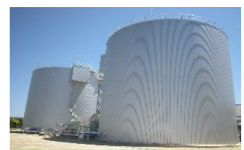
汚泥消化施設の導入によるバイオガス発電 (○○○○t-CO 2 削減)
