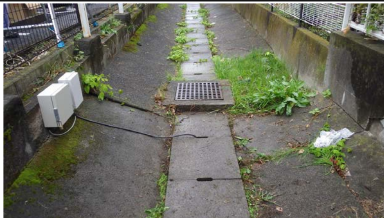
設置後(センサー部を主に可能な範囲で全景)
