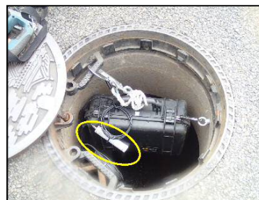
人孔内での設置状況 ※着色部はシリカゲル入りチューブ
