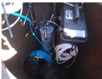
記録装置の設置状況
