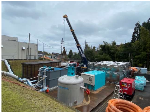
宝立浄水場可搬式浄水装置 (名古屋市上下水道局)
