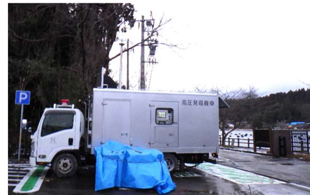
電源車の設置(穴水町穴水T)
