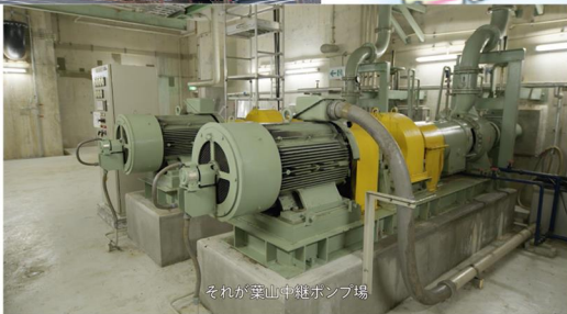
それが葉山中継ポンプ場
