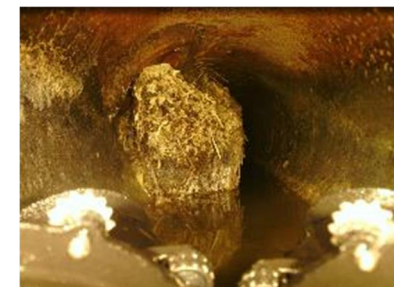
木根侵入を確認した事例
