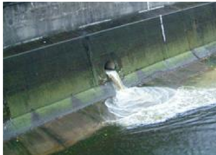
雨水吐からの放流状況
