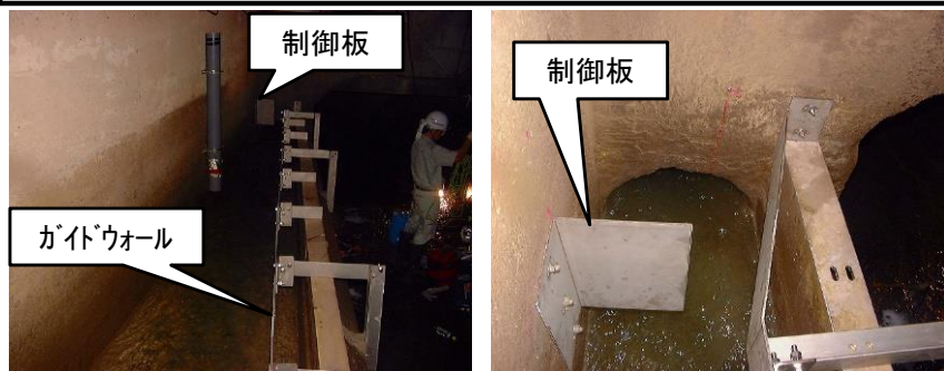
水面制御装置全景
