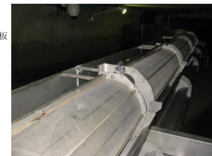
ストームスクリーン設置状況
