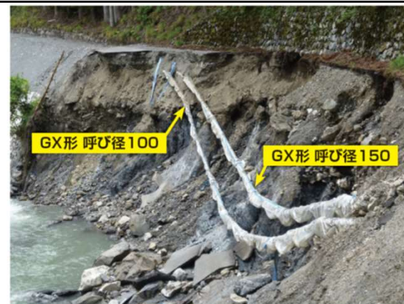
耐震継手管被災状況 (被害無し)
