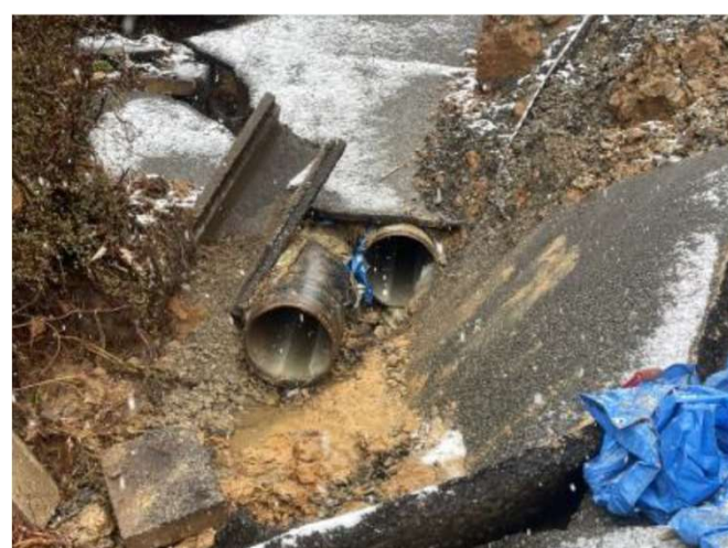
輪島市 送水管損傷
