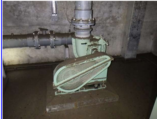
地下階での機器部水没(珠洲市野々江P)
