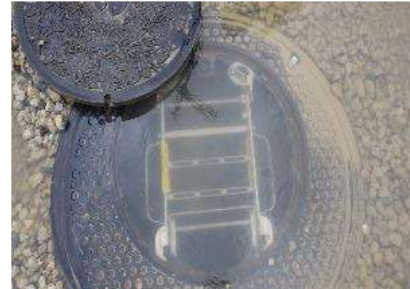
人孔内滞水(七尾市)
