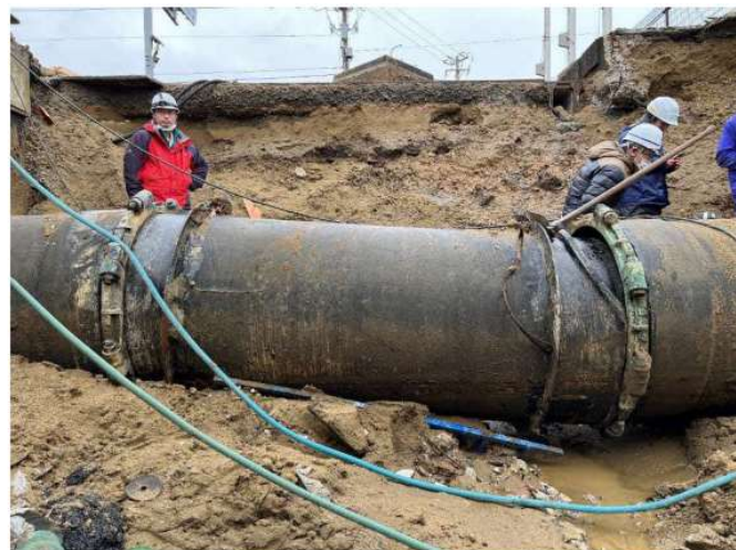
七尾市 送水管損傷
