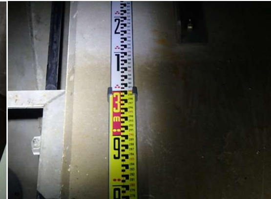
地下浸水レベル(輪島堀町) (地下1階床上+2.99m)
