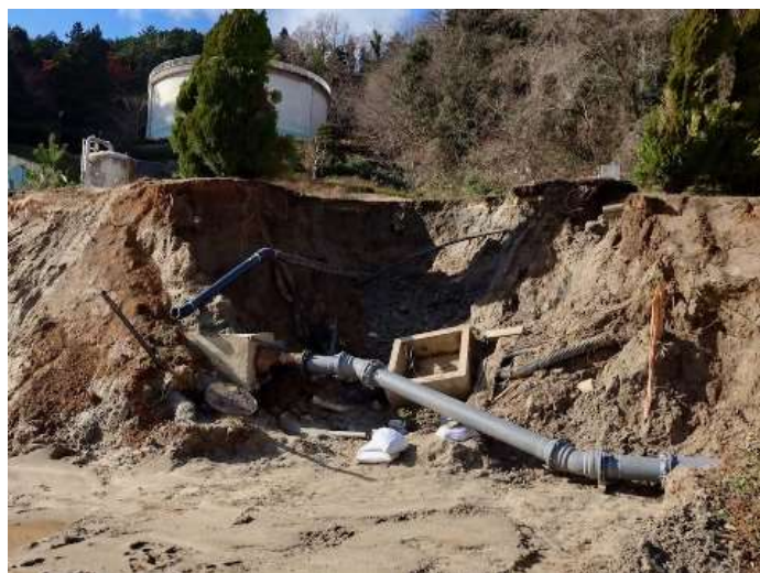
【被害状況】七尾市岩屋浄水場（場内配管損傷）
