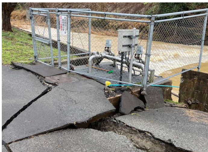
【被害状況】珠洲市宝立浄水場（取水口）
