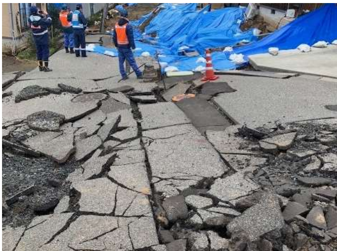
能登町 水道管損傷
