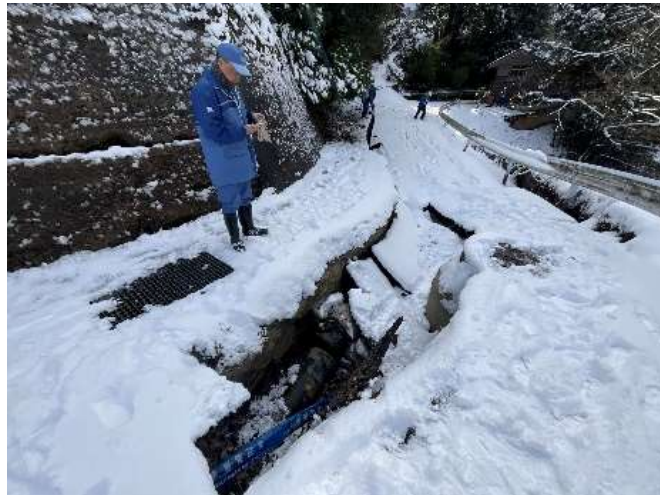
輪島市 送水管損傷
