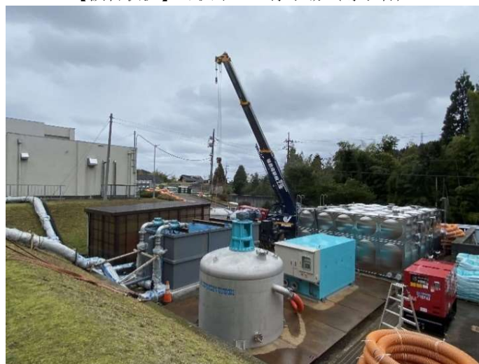
【応急復旧】珠洲市宝立浄水場（可搬式浄水装置）
