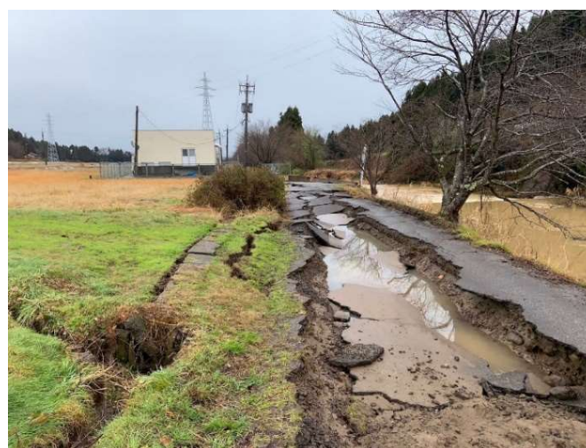
【被害状況】珠洲市宝立浄水場（導水管）
