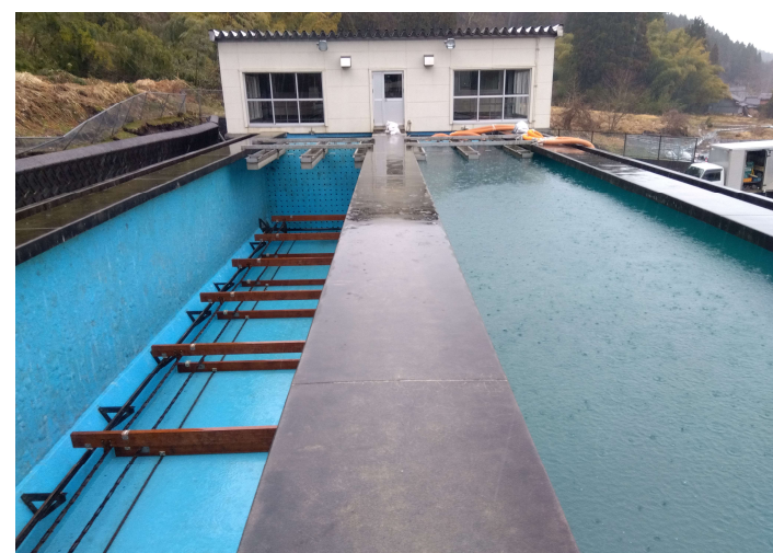
【被害状況】珠洲市宝立浄水場（沈殿池）
