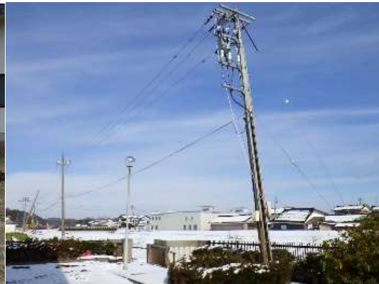
引込柱傾斜(珠洲市熊谷P)
