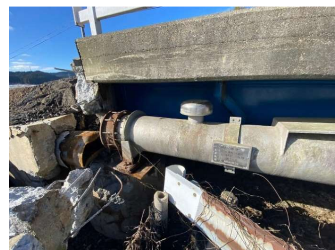
珠洲市 水管橋損傷
