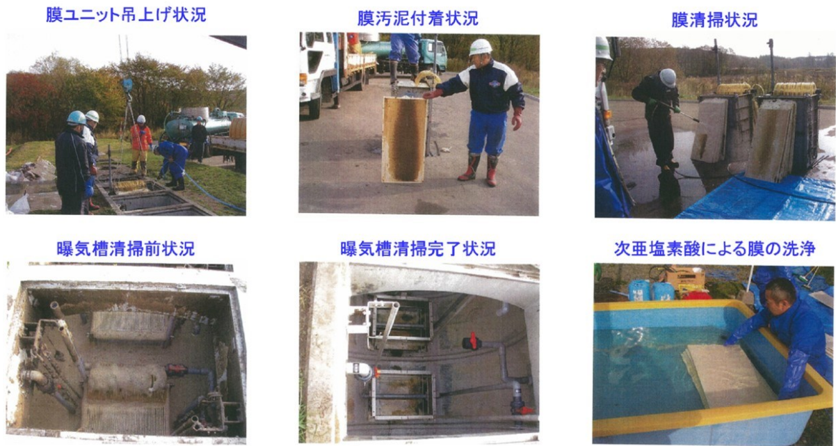
図 4-1 維持管理状況（礫分内終末処理場）
