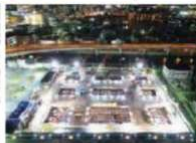
雨水ポンプ場
