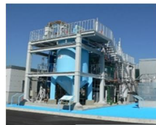
リン回収施設
