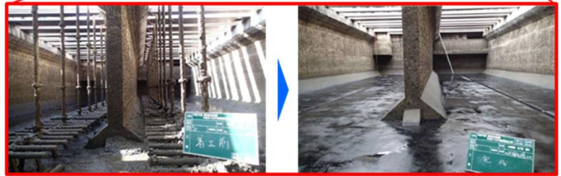
既存施設を調整池等に改造するイメージ (例：施設内の設備撤去状況)
