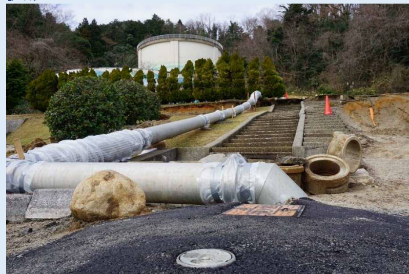
【岩屋浄水場の仮設配管】
