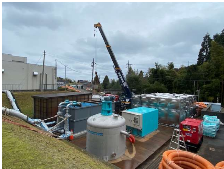
宝立浄水場可搬式浄水装置
