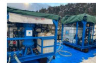
可搬式浄化装置（珠洲市） （水資源機構）
