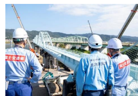
地方整備局による現地調査 (令和3年和歌山市 六十谷水管橋崩落事故) むそた
