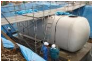
工場製作型 極小規模処理施設
