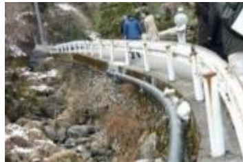
クイック配管 (露出配管)
