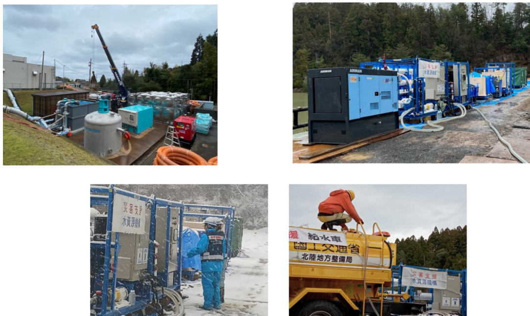
図 5 - 10 可搬式浄水施設・設備の活用
