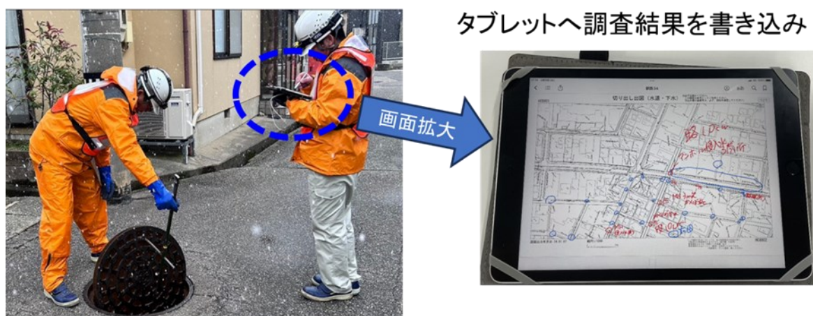
図 5 - 1 3 下水道施設被害調査におけるデジタル技術活用事例 (熊本市による一次調査)
